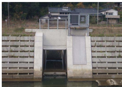
写真 4.1.1-2 起伏式ゲート樋門
